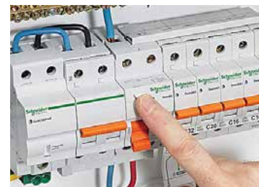
Před opuštěním bytu vypněte pojistky, uhasťte otevřený oheň ve spotřebičích a uzavřete hlavní přívody vody a plynu. V přízemí a suterénu utěsňte toaletní mísy, kvůli zpětnému vzduťí vody v kanalizaci.
