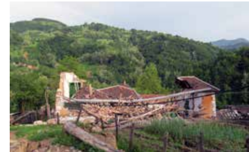
Povodně z přivalových srážek mohou způsobit destrukci i domů, které stojí na kopci daleko od řeky.
