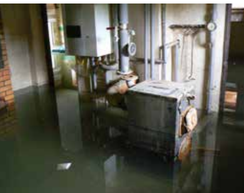
Těžké technologické vybavení pravděpodobně nestihnete včas vystěhovat. Umístěte pokud možno technologické vybavení domu mimo dosah povodně.
