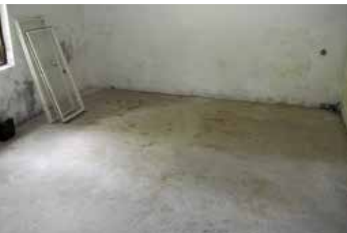
Škody v prázdném bytě jsou výrazně nižší.
