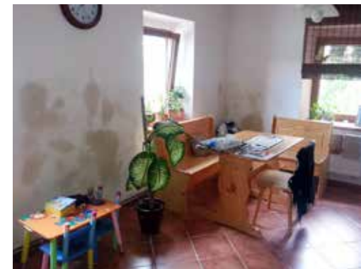
Uspěchaní oprav a předčasné zabydlení vede k vystoupení vlhkosti ze zdiva na opravený povrch.
