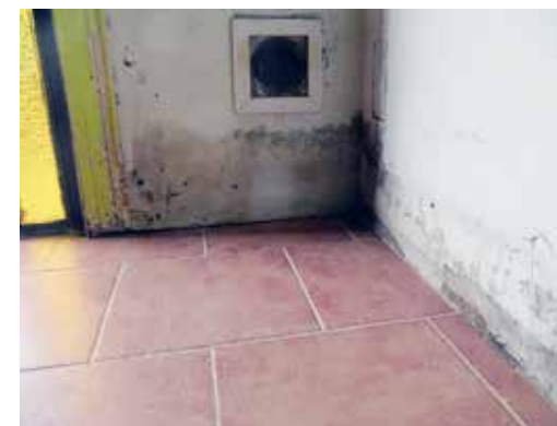
Nedostatečné vysušení a větrání vede k rozvoji plísní.
