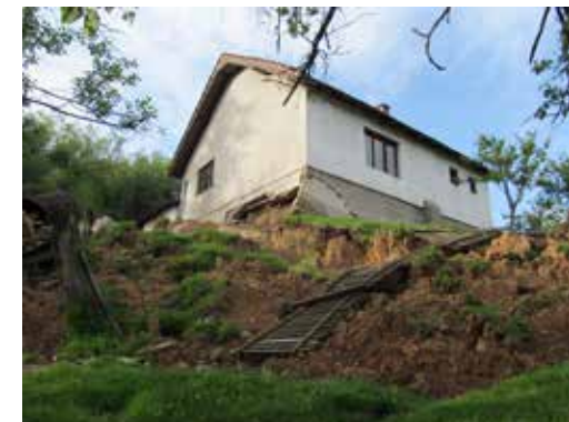
Přivalové srážky mohou způsobit podemletí základů.
