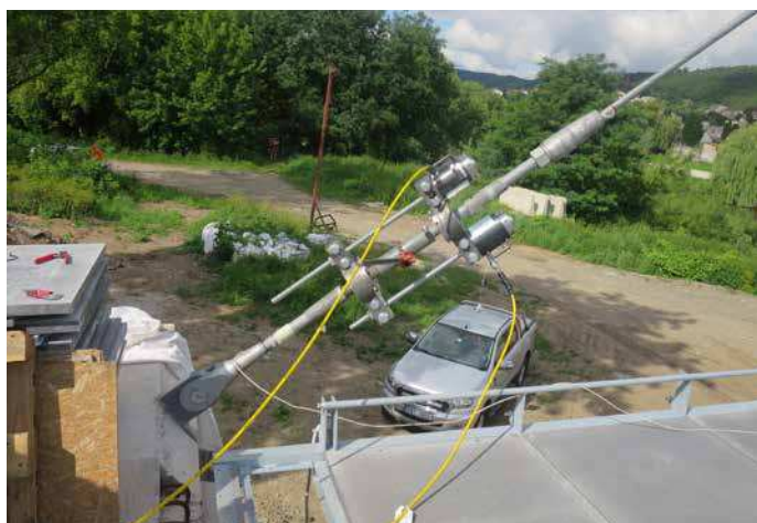
▲ Obr. 18 Zakončení lana s hydraulickým zařízením a tenzometrem na zbraslavské opěře
